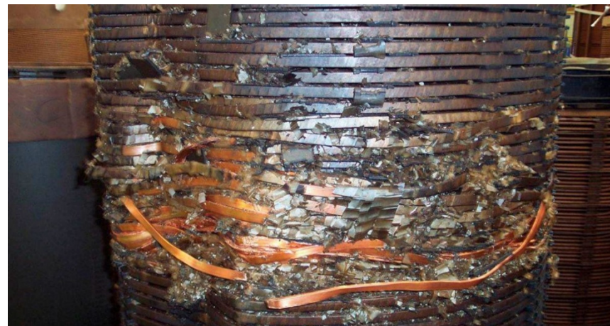
Разрушение витковой изоляции – наиболее частое повреждение
